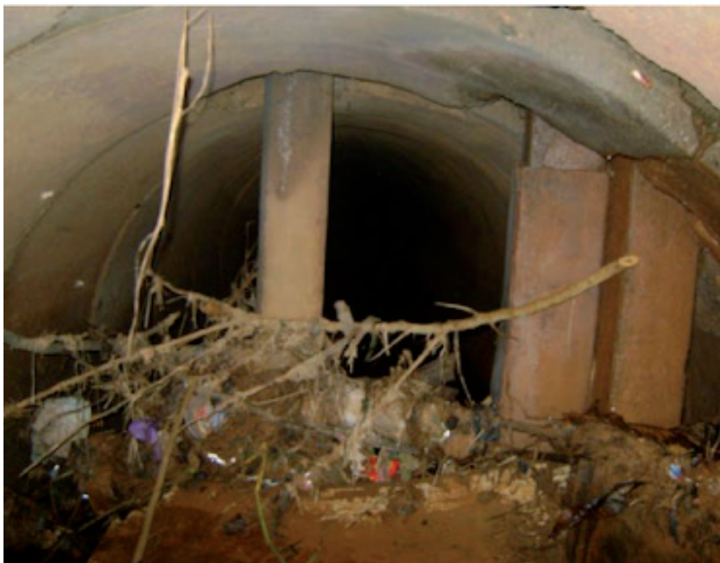
Figura 4 – Situação, em 2022, do Rio Cancela, canalizado subterraneamente e com lixo. Fonte: Wittmann (2022).
