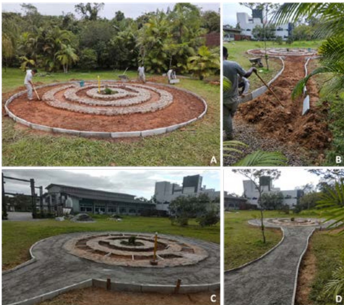
Figura 28 – Jardim Sensorial do Jardim Botânico da Univille. A, C: obra em andamento; B, D: construção do acesso. Fonte: Primária.
